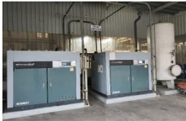
Gambar 18. Sebelum Ada Panel Sistem Monitoring Alarm
