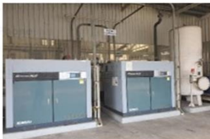
Gambar 19. Sebelum Ada Panel Sistem Monitoring Alarm
